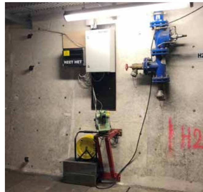
Een volautomatisch meetstation zorgt voor een constante monitoring in de tunnel.
