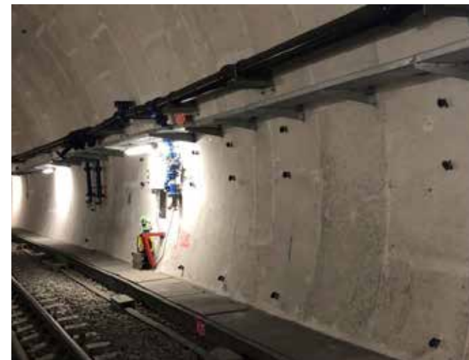
Er werden 95 onbemande prisma's tegen de tunnelwand bevestigd, die door het meetstation worden ingemeten.
